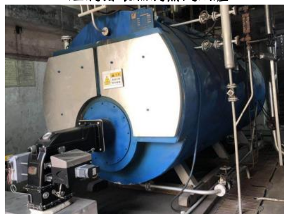
燃氣蒸汽鍋爐
